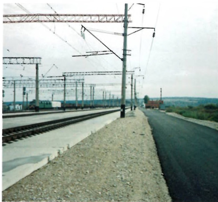
Станция Агрыз. Переснащение ПТО вагонного депо до уровня общесетевого значения (подготовка основания и укладка плит). 2002 г.
